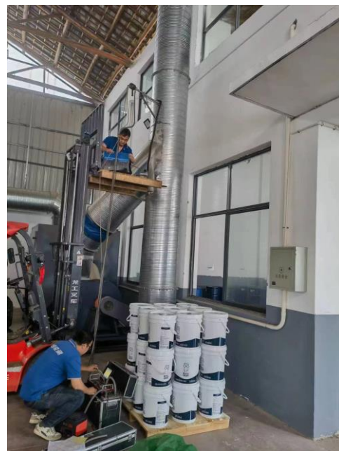
图 3-5 废气处理现场图
