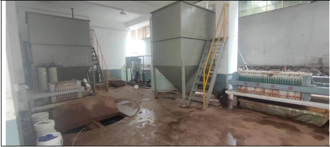
图 3-3 污水处理站现场图
